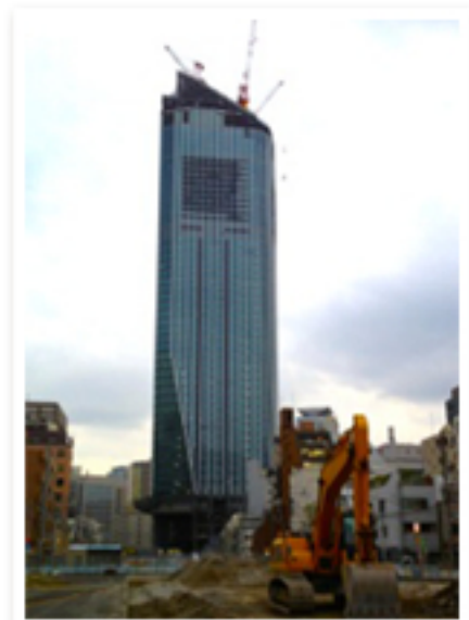
建築中の「虎ノ門ヒルズ」。このビルの地下1階を環状2号線が貫通する
